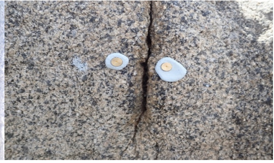
Fotoğraf 22: Çatlak oluşumu
